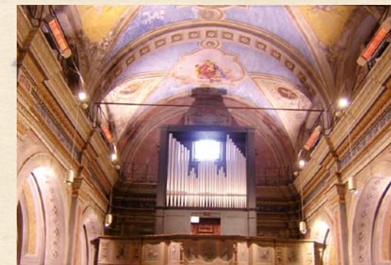
Impianto di irraggiamento SUNRAD presso la Parrocchia S. Giovanni - Monteu da Po (TO)
